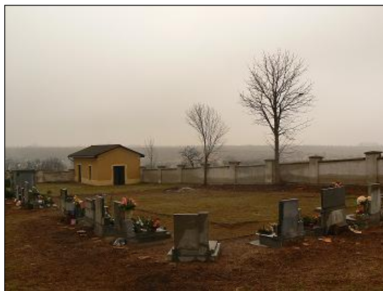
obr.č. 137 Dva ořešáky královské, které narušují stabilitu hřbitovní zdi, pohled na severovýchod.
